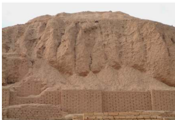
■ شکل ۴۱: فرسایش شدید هسته خشتی زیگورات در جبهه شمال شرقی (مأخذ: نگارنده، ۱۳۷۸).
